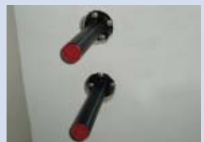
An der Keller-Innenwand sind für den Installateur die fertigen Anschlüsse inkl. Absperreinrichtung vorbereitet.
