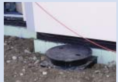
Im Schacht außerhalb des Kellers befinden sich die Verteiler für die Sonden.
